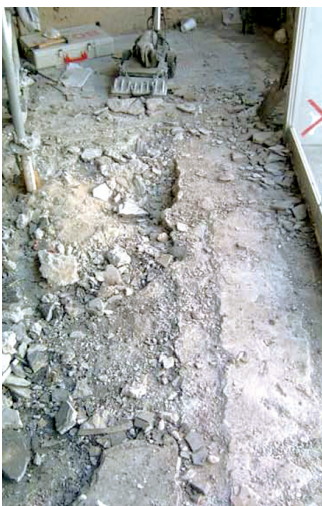
Weitgehend zerstörter Estrich nach Entfernen der Altbeläge im Eingangsbereich
